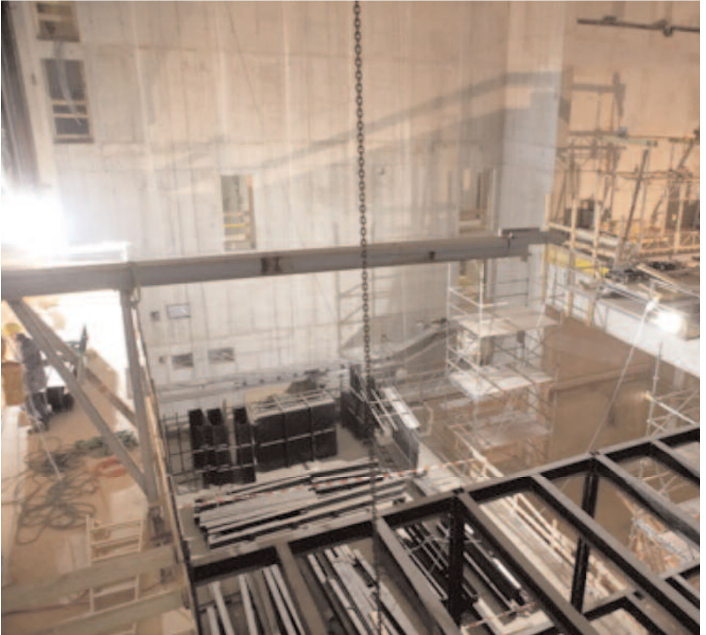
Einblick: Hintergrundinformationen, Pläne und Bilder zur Sanierung im Ronacher Theater gibt es im Internet unter www.ronacher-funktionssanierung.at
